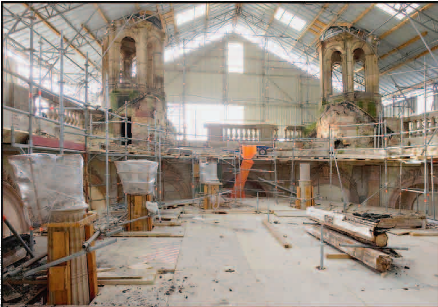
Chantier du château de Lunéville après l'incendie de 2003. Aujourd'hui, toitures et façades sont presque terminées.
